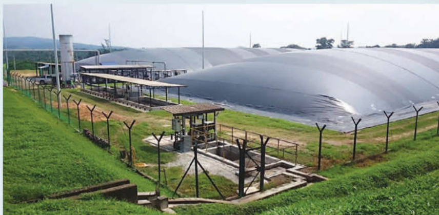
Hầm biogas trang trại chăn nuôi
